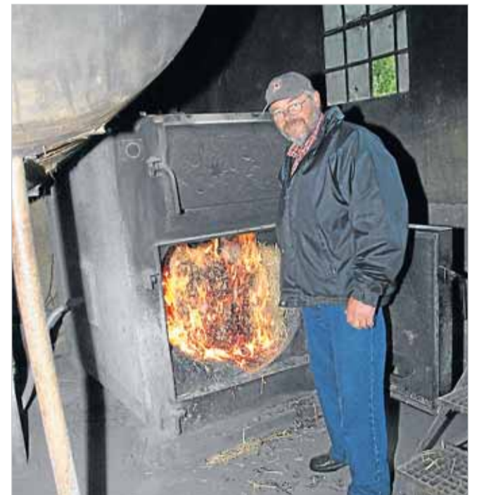
For 27 år siden installerede Holger sit halmfyr her i det gamle hønsehus.
